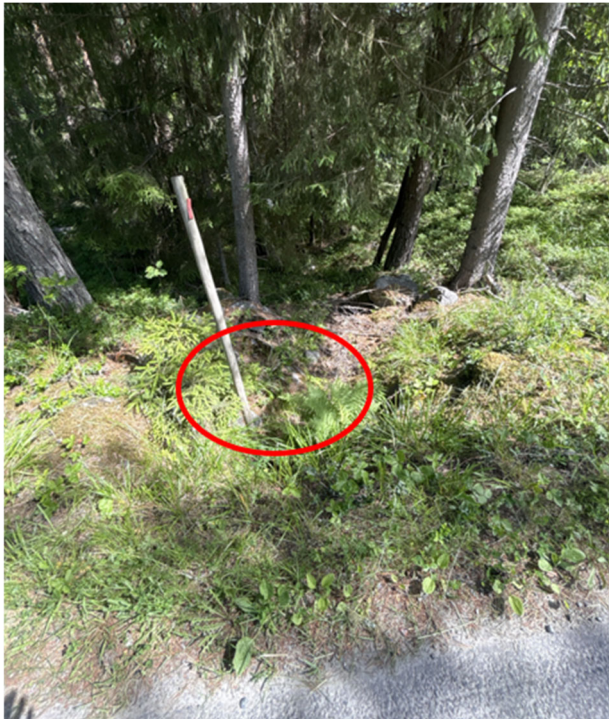
Figur 3-7: Bilde viser tørrlagt utløp til kulvert under Bårlivegen (rød sirkel). Bilde tatt mot øst. (Bilde: COWI).
