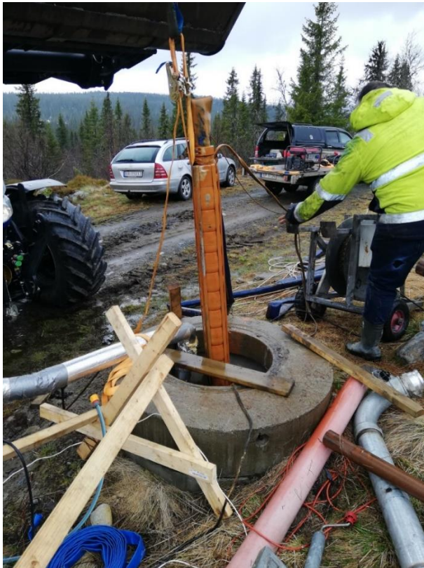
Figur 12: Jernutfellinger på pumpe som viser at det er mye jern i grunnvannet.
